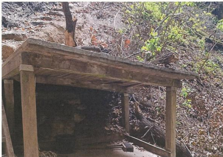
Obrázek č. 13 provizorně opravená plošina u Jezírka.
