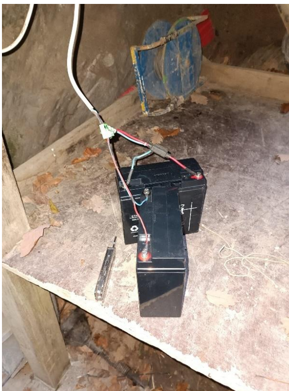
Obrázek č.1 – výměna baterií v ústředně teplotních čidel.
