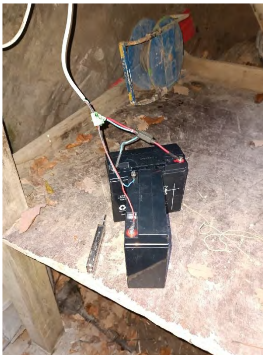
Obrázek č.16 – výměna baterií v ústředně teplotních čidel.
